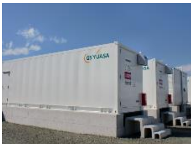
Außenansicht der Lithium-Ionen-Batteriecontainer von GS YUASA.
